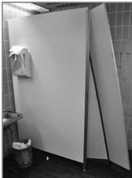
En delevegg på herretoalettet er revet ned og gjort toalettet ubrukelig på Moelv stasjon.
